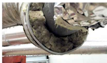
Bsp.: 2_Rohrummantelung aus KMF
